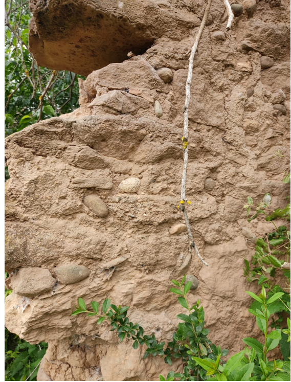
Restos del recobrint exterior, amb morter tou de calç i reforçament de petites pedres.
