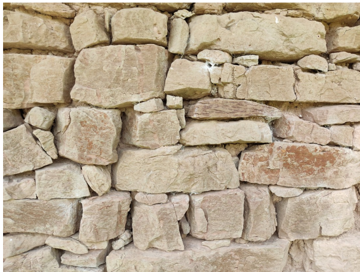
Pèrdua del morter de garsa a la cara exterior del mur per filtracions. Cabanya del Cerdanya , Oristà.
